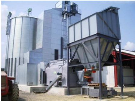
Générateur d'air chaud à biomasse du site de Lescurry
